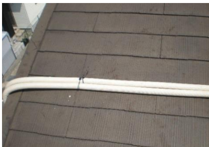
屋根上を這う配管
